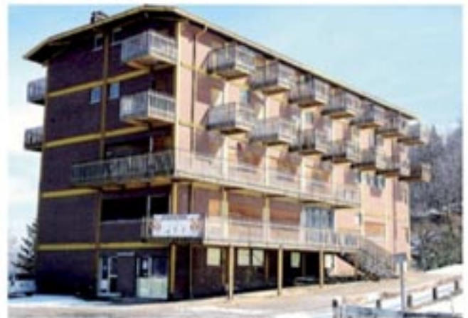
L'ex albergo della Conca dell'Alben che sarà demolito. Al suo posto un centro servizi per il turismo
